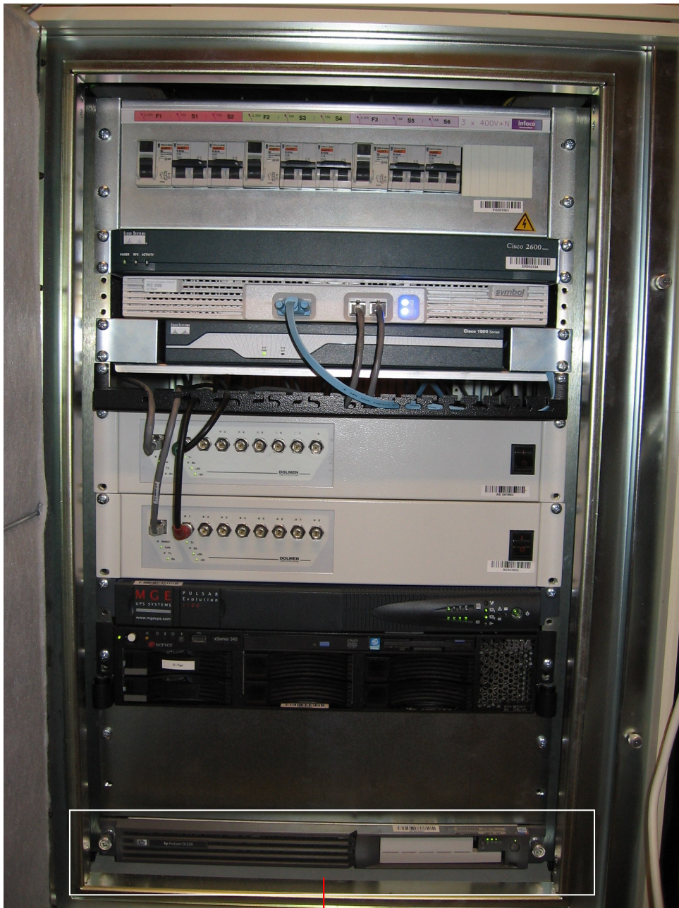
Onze 1U-server in een mogelijke rackopstelling
